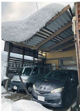
破損したカーポート
