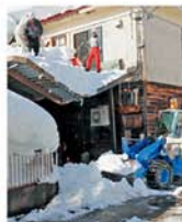
損傷カーポート除雪
