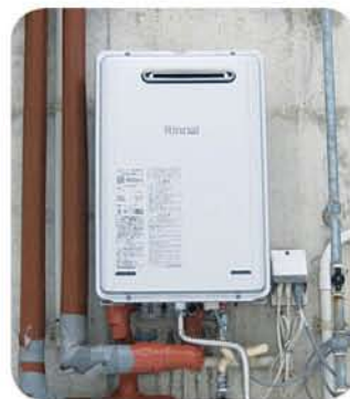
配膳室用に設置されたガス給湯器
