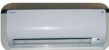
配膳室に設置されたエアコン
